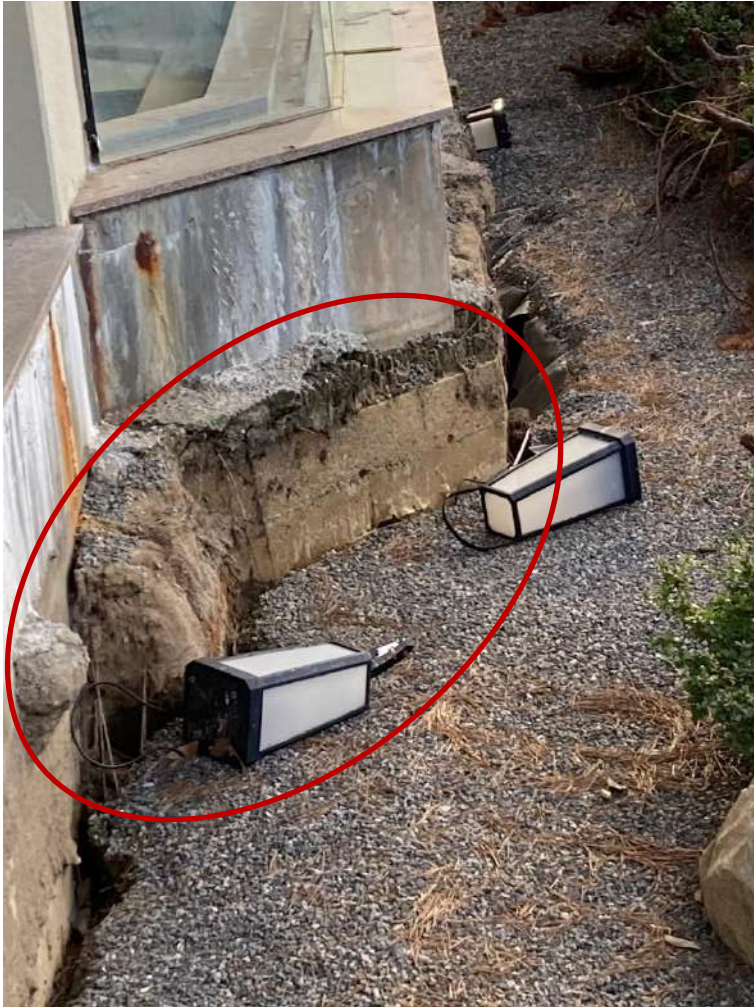
大浴場の外が、地盤沈下
