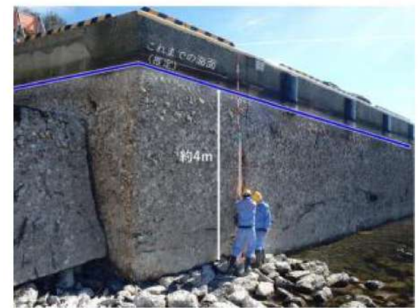
鹿磯（かいそ）漁港で約4mの隆起を確認
